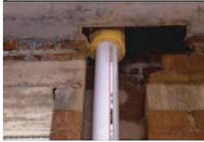
Resim 1. 1. 3: PVC boruların duvar geçişi
